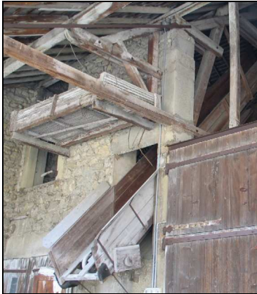
Monte-foin en place sur une grange
